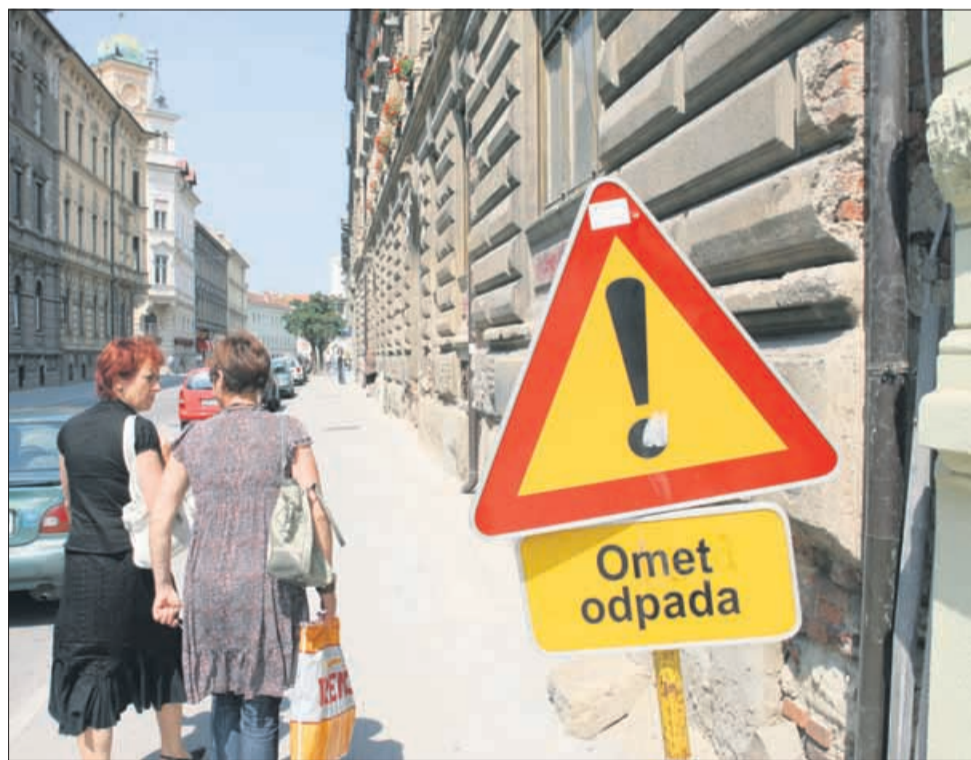
Fasade zgradb v Cankarjevi ulici so postale ne le neprijetne na pogled, ampak tudi nevarne. Za njihovo obnovo pa lastniki nimajo denarja.
