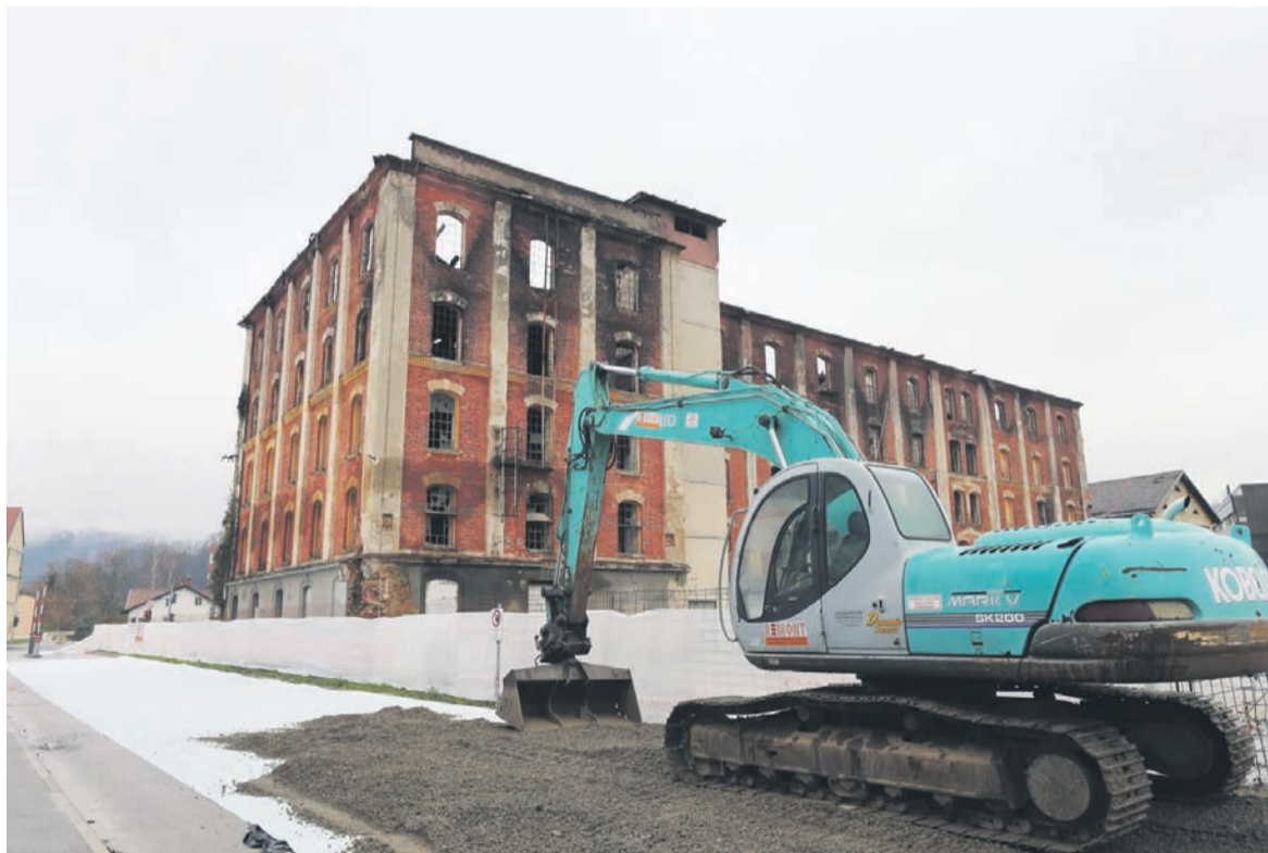
Celjsko gradbeno podjetje Remont je v torek prevzelo požarišče, včeraj so opravili še nekatera pripravljala dela, prav danes, v četrtek, pa bodo stavbo začeli rušiti.
