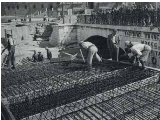
Fotografiji zgoraj: Gradnja Tromostovja v Ljubljani v začetku 30-ih let 20. stoletja, armiranje mostnih lokov. (SI_ZAL_LJU/0342, Fototeka A02-107, A02-110).
