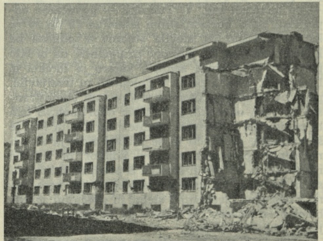
Sl. 2. Zgradba št. 88, katere vzhodni del se je porušil
