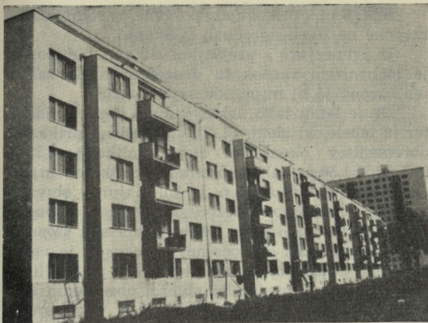
Sl. 3. Zgradba št. 80, ki je le močnejše poškodovana Poškodbe so v glavnem omejene le na pritličje
