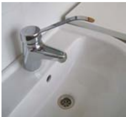
Slika 6: Vodovodne pipe imajo daljše ročaje. The handles of taps are longer.
