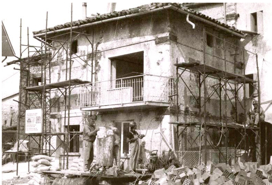
Slika 2 • Hiša, ki jo je po majskem potresu leta 1976 v Benečiji utrdila ekipa ZRMK, je septembrski potres istega leta prestala brez poškodb (arhiv ZAG, foto E. Vugrinec)
