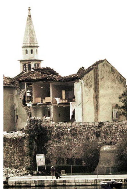
Slika 4 • Budva, 1979: porušitev zidu zaradi nihanja pravokotno na ravnino
