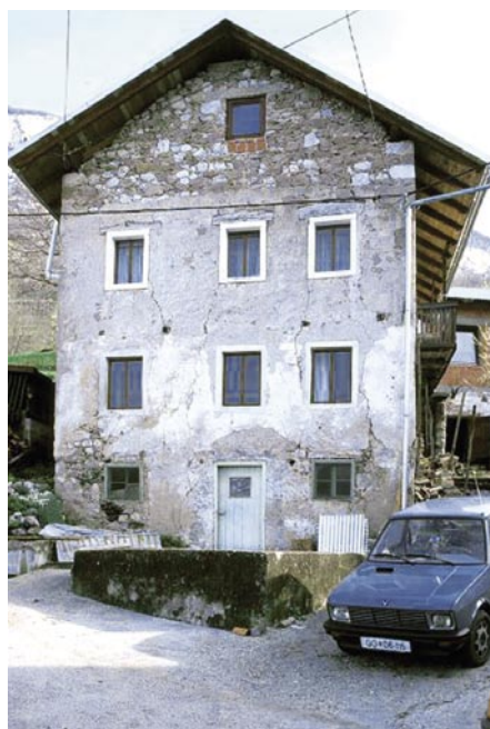
Slika 3 • Posočje, 1998: navpične razpoke so nastale zaradi nihanja zidu pravokotno na ravnino
