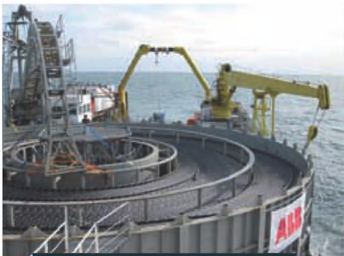
Na ladjah je več tisoč kilometrov optičnega kabla zvitega v kolutu, ki ga počasi odvijajo, ko kabel previdno polagajo na morsko dno. Vir: ABB Group.
