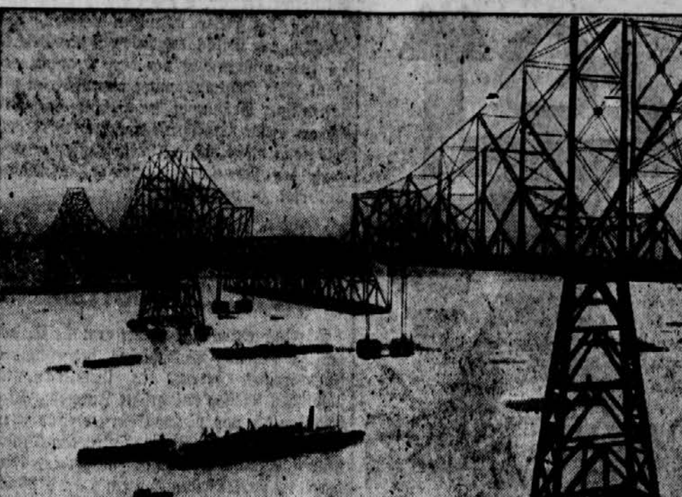
Die neue große Eisenbahnbrücke an der San-Francisco-Bai, bei dem Emporsteigen des Mittelteils.
