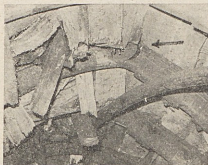
Slika 2 Stropni segment je počil zaradi premočnih deformacij (Foto J. Kirič)
