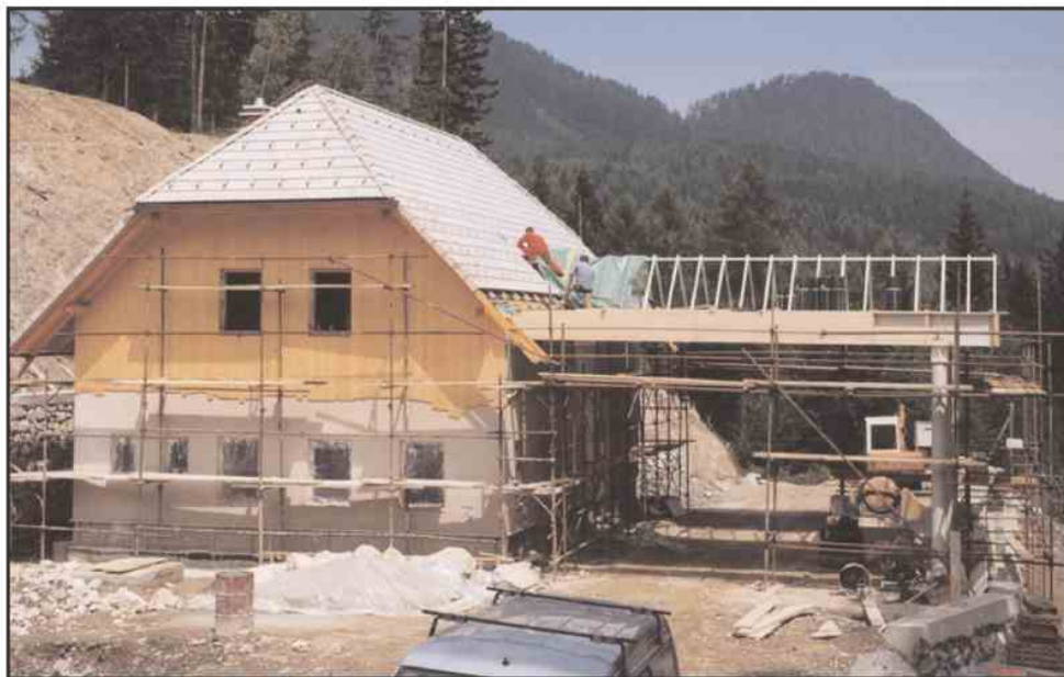
Lep objekt za potrebe obmejnih služb obeh držav stoji na slovenski strani, gradbinci pa so se pri tem še posebej izkazali
