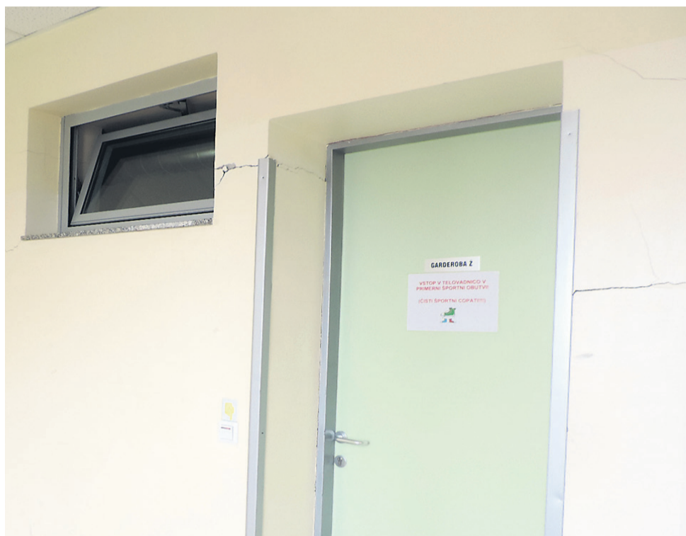
Ob ogledu prizidka je bilo ugotovljenih več poškodb objekta, od razpok na stenah, poškodb podbojev, lukenj ob stikih sten in tal v telovadnici ter zunaj objekta.
