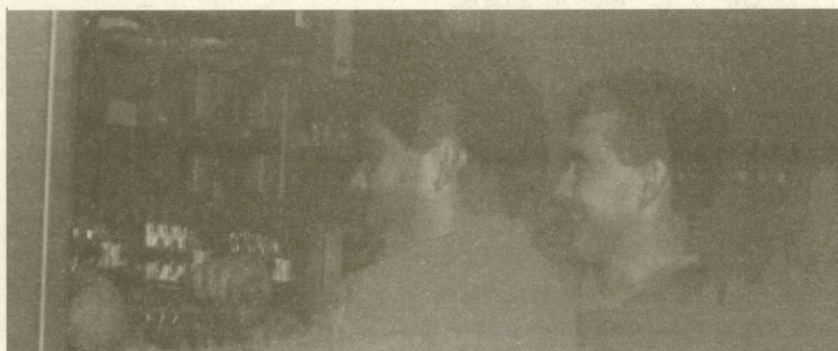
V trafo postaji sta Matjaž in Marko pregledala vse stikalne elemente in po potrebi zamenjala posamezne dele.
