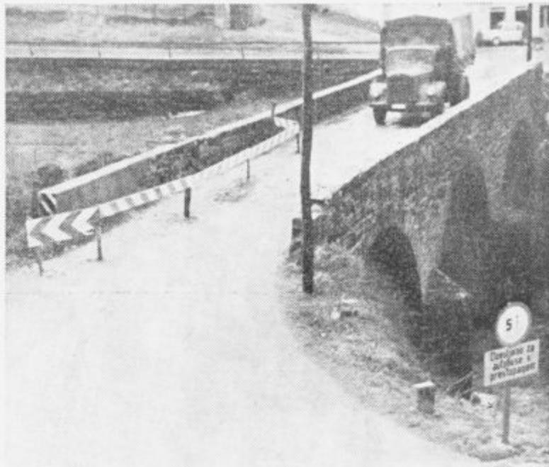
Malomarnost svoje vrste. Kdo se še spominja, koliko časa je premski most takole »opremljen«: ograja okrog nevarnega in sumljivega mesta in opozorilo, da je prestopanje »dovoljeno« in da se več kakor pet ton ne sme cijaziti preko ...
