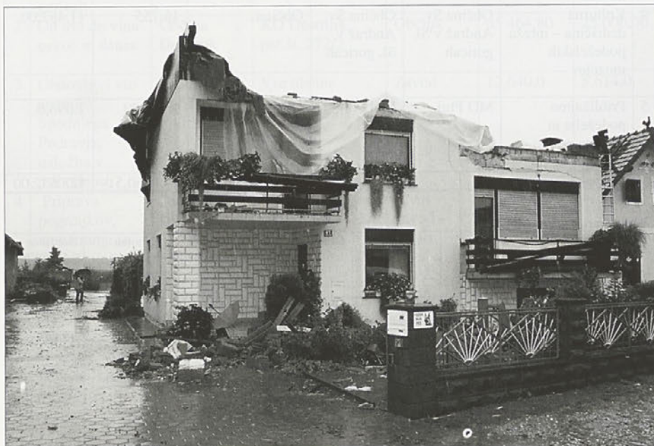
Družina Vogrinec na Zg. Hajdini je samo v nekaj minutah ostala brez strehe nad glavo. V oktobru so Voginčevi na temeljih stare že zgradili novo hišo Foto: TM
