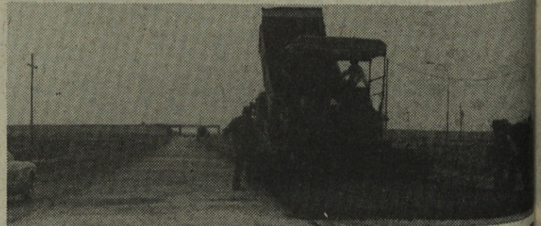
Čeprav je Amara znana po suhem in vročem podnebju, nam je 11. aprila 1981, ko smo polagali prve kvadratne metre bitugramoza, nagajal dež. Pomoč pri asfaltiranju nam pomagajo delavci Cestnega podjetja Maribor
