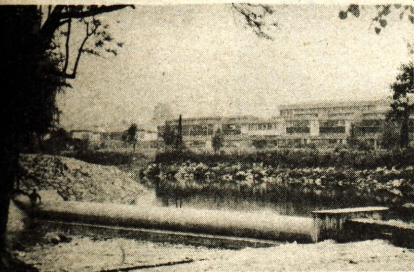
Obnovljen Krevsov jež v Škofji Loki — Sora v Škofji Loki ne bo več poplavljal Podna na levem bregu. Dela pri obnovi in ureditvi Krevsovega jez, ki jih je dobro leto izvajalo Vodno gospodarstvo podjetje Kranj, investirala pa jih je Območna vodna skupnost Gorenjske, so ta teden končali. V sredo dopoldne so preizkusili napravo, tako imenovani mehki jež, ki bo avtomatsko reguliral gladino Sore. Naprava oziroma gumijasti mehur je v celoti izdelal Save Kranj, takšna izvedba pa je desetkrat cenejša od drugih načinov avtomatskega reguliranja gladine. Več o tem na 4. strani. — A. Žalar
