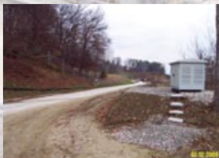
Začasna trafostaja z dovozno cesto
