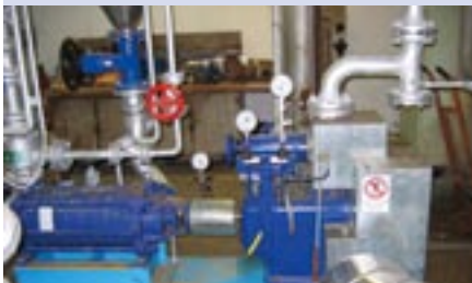
Napajalna črpalka KSB in turbina KKK
