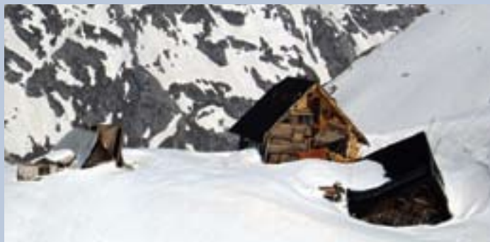
Plaz je hudo poškodoval kočico na Doliču.
