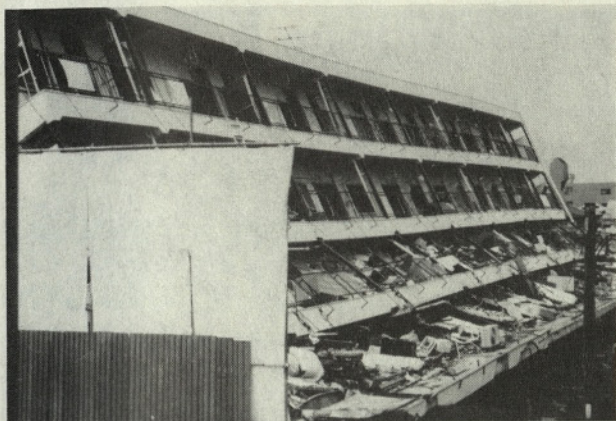
Slika 8. Porušitev pritličja armiranobetonske stavbe.
