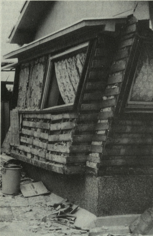
Slika 6. Neustrezna konstrukcija stare lesene hiše.
