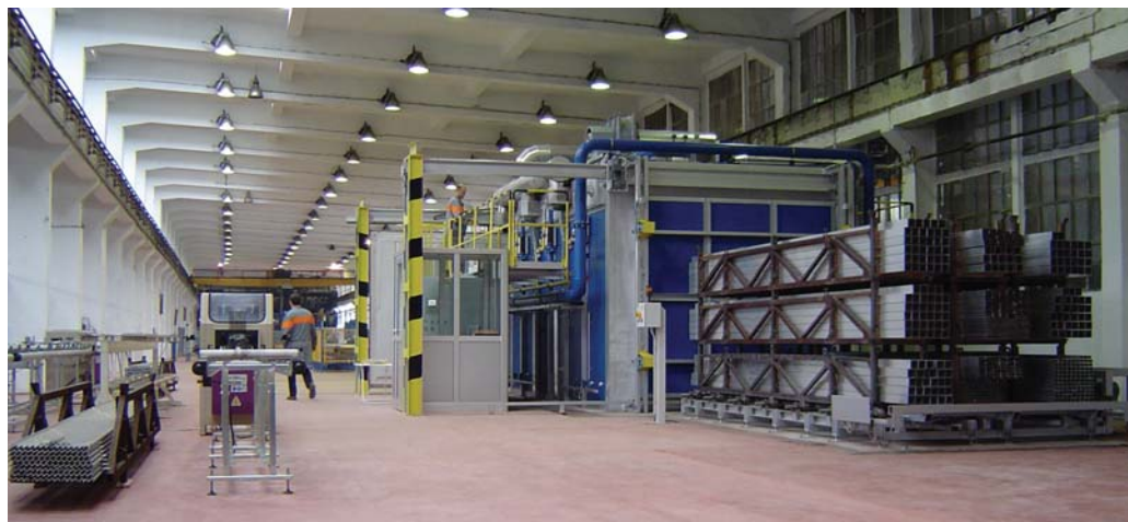
Tunelska peč za termično obdelavo aluminijastih profilov
