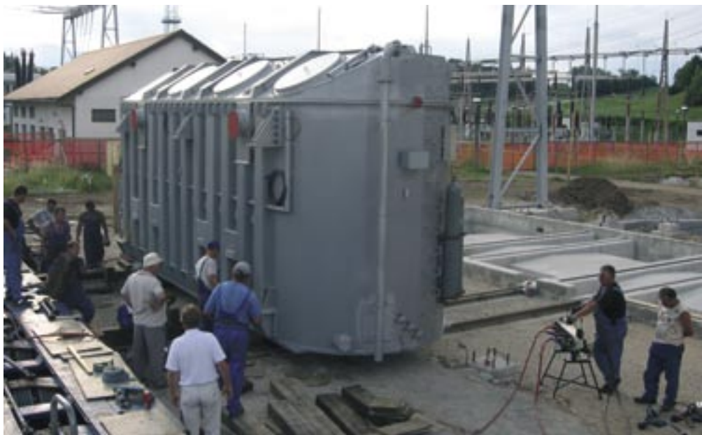
Nov transformator bo imel še boljše obratovalne značilnosti od dosedanjih.
