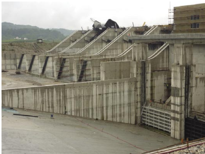
Slika 3 • Glavna gradbena dela na strojnici in prelivnih poljih HE Brežice so praktično končana, nameščen je tudi velik del »težke« opreme. Pretočni trakti so zaprti in na celotnem objektu poteka montaža opreme. Preusmeritev Save je načrtovana za konec julija in avgust 2016, polnitev bazena pa novembra letos
