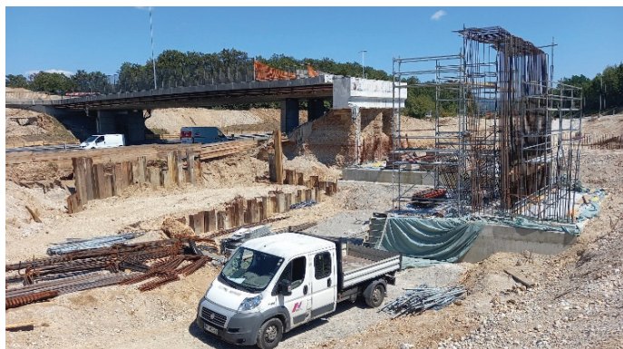
Slika 6. Zavarovanje izkopa gradbene jame, temelj in stena novega nadvoza čez HC. Na stari nadvoz se bo priključil nov nadvoz, avgust 2022.
