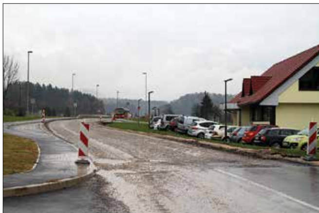
Do praznikov so delavci pripravili cestišče za asfaltiranje, grobo maso nadgradili s fino in s semaforji uredili promet po polovici ceste. (Foto: Benjamin Kanjir)
