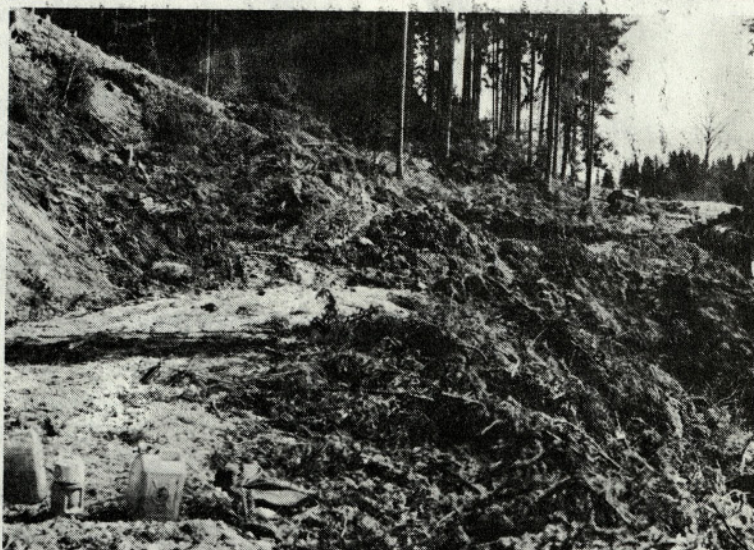
Skoraj končano gozdno cesto v "Grofiji" je zasul zemeljski usad - foto GG
