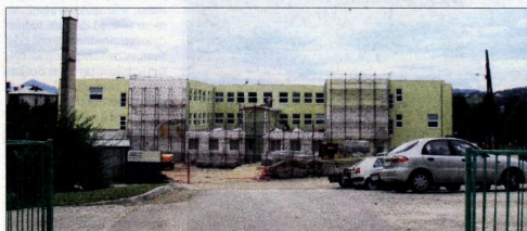
Veliki prizidok osnovne šole v Vojniku po nepričakovanem podpirju starega jedra šole. Veliko staro jedro bo zamenjala nadomestna gradnja.
