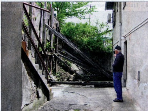
«Če bi parada Piva in cvetja potekala mimo to sramote, bi bila že zdavnaj sanirana,« ugotovljajo stanovalci.
