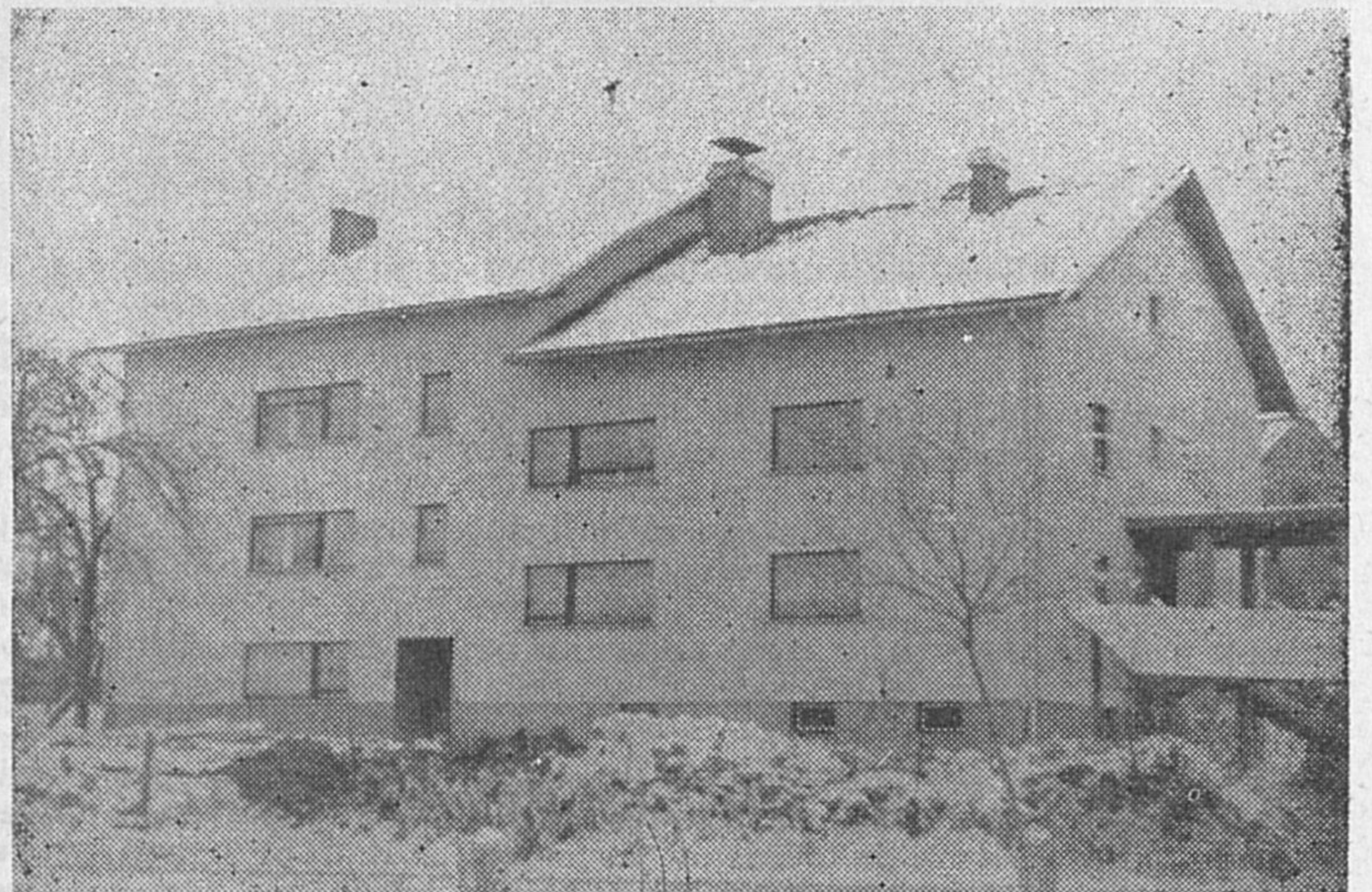
Upravna stavba s stanovanji GG Postojna v Starem trgu je v glavnem dograjena. Urediti je potrebno še kanalizacijo, okolico in nekaj manjših komunalnih ureditev. Vselili se bodo v začetku 1965. leta.
