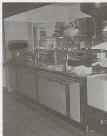
Obnovljena razdelilnica toplih obrokov
