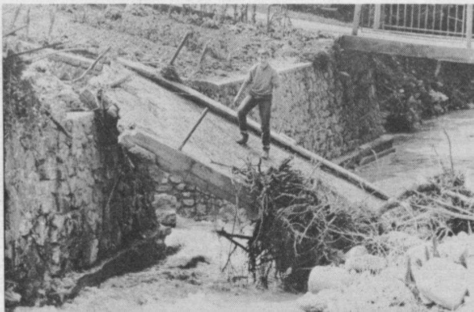
Most pred trgovino v Tevčah je popustil pod težo vejevja in kamenja, ki se je valilo in plavalo po narasli Lahomnici.
