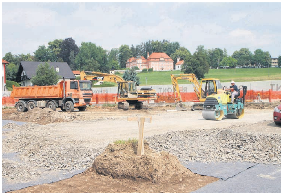
Izvajalec del je Remont, ki na podlagi obstoječega gradbenega dovoljenja izvaja zemeljska dela. Stanovanja naj bi bila zgrajena v drugi polovici prihodnjega leta.
