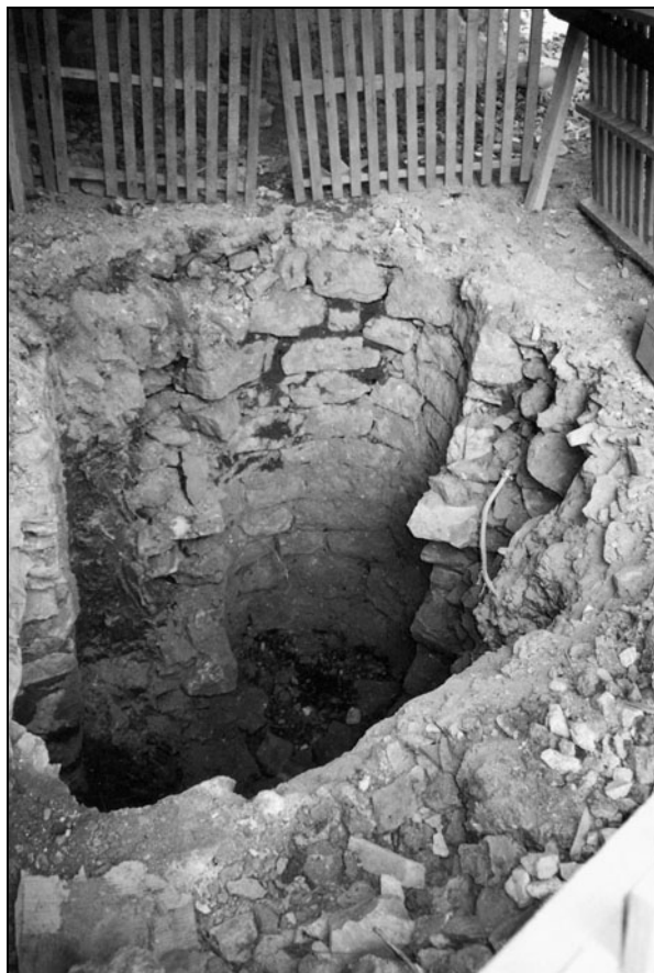
Ob prenovi hiše Štanjel 22a se je v podbodu pokazal podzemni vodni zbiralnik z jasno čitljivo zgradbo. Foto: E. Belingar, 2004.
