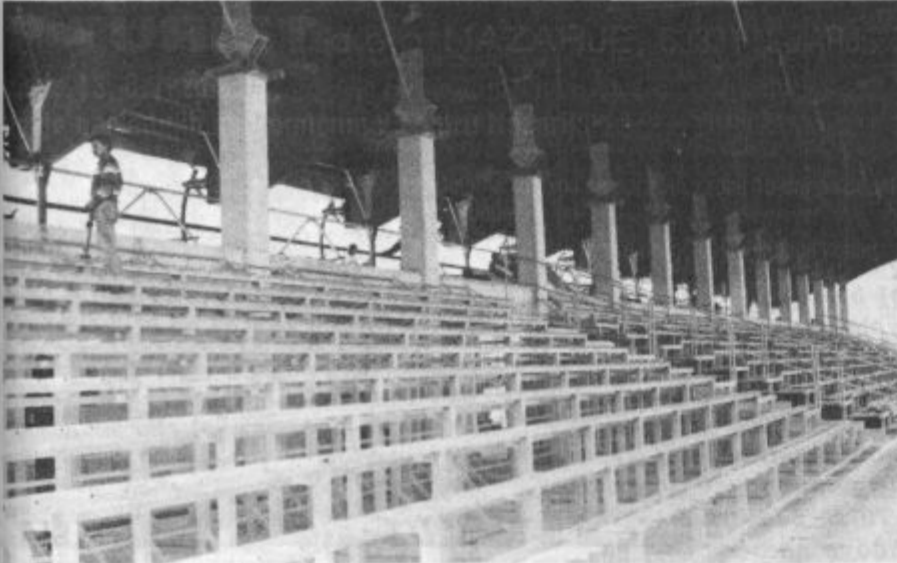
V ospredju montaža premičnega dela ograje, zadaj oblaganje jeklenega dela konstrukcije z lesom.
