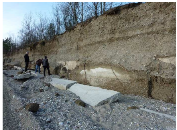
Slika 3: Porušeni segmenti (dvojne?) diafragme.
