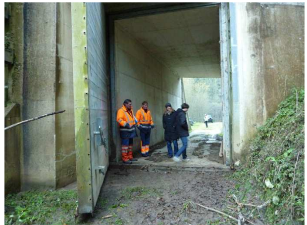
Slika 14: Dostopni »tunel« skozi pregrado z vodotesnimi vrati.
