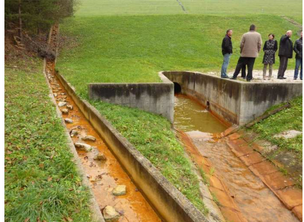
Slika 5: Ohrapavljeno dno drenažnega kanala in eden od glavnih drenažnih iztokov.
