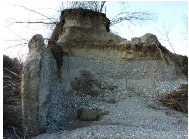
Slika 2: Prezrez porušenega nasipa; levo je vidna betonska diafragma.
