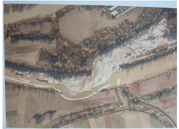
Slika 8: Situacija poškodbe po dogodku (voda v kanalu teče od desne proti levi, preboj se je zgodil na desnem bregu in povzročil zajedo na levem).
