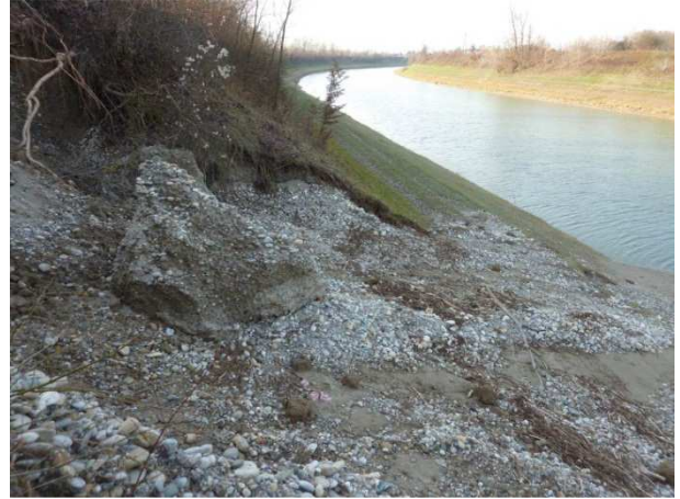
Slika 7: Ena od gorvodnih lokacij poškodb.
