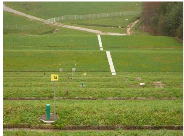
Slika 2: Dolvodno lice pregrade z oznakami sistema monitoringa.
