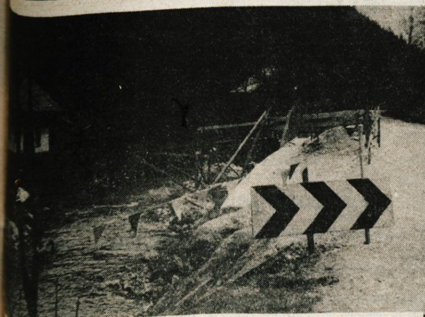
Najbolj kritična točka na cesti od Radovljice do Kropše je sedaj varno obdružena, saj so naredili betonsko zaščito, da voda ne more več spodkopavati ceste in delati škode. — Foto: F. Debeljak
