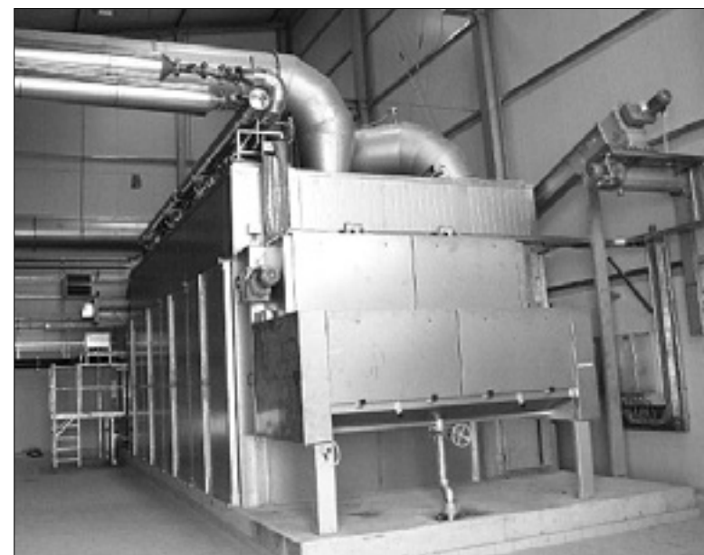
Naprave so pripravljene za čiščenje odpadnih voda
