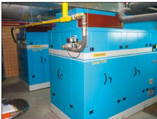
Enoti kogeneracijskega postrojenja v Park Hotelu Bohinj
