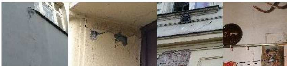
Fotografije zgoraj: Razpoke na objektih kot posledica izkopa predora Mrazovka (vir: Butovič, 2004)
