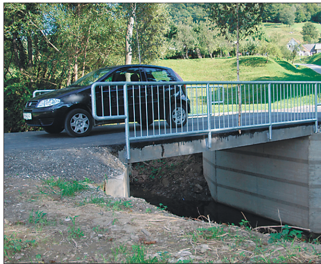
Novi most v Skrbljah čez potok Skraljška je veljal dobrih 5 milijonov. Foto: M. Ozmeč
