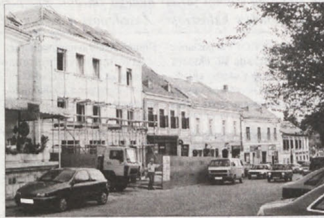
ŠE GRADBIŠČE - Bodoča blagovnica je še veliko gradbišče, že čez dober mesec pa bo ena najbolj opaznih stavb na Glavnem trgu. (Foto: J. D.)
