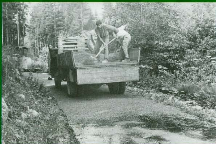
Gradili smo ceste. Priprava (peskanje) cestišča Ravne - Uršlja gora za asfaltiranje leta 1968
