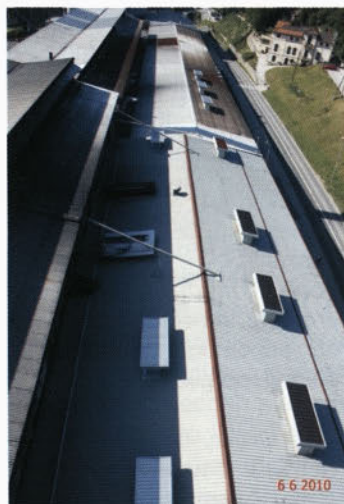
Odvodni jaški vročega zraka na strehi nad pregledom
