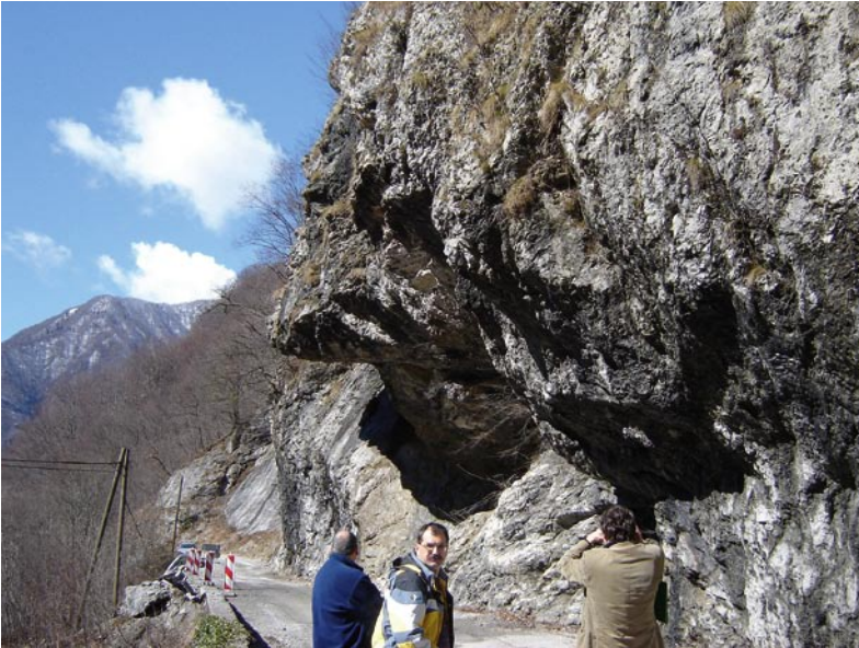
Slika 8. Previsna brežina po podoru na cesto v Baški grapi
