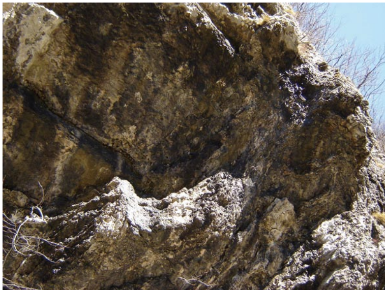
Slika 12. Razpoklinska cona pod previsom pred izvedbo sanacije: oksidirane in kalcitizirane delno odprte in kavernozone razpoke: območje GSI = 43 do 47.
