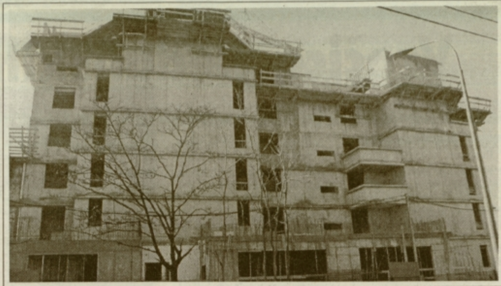
Gradnja stanovanjskega naselja Nove Poljane je posel desetletja v Ljubljani in tudi za Vegrad. Stanovanjski sklad je z dosedaj opravljenim delom zelo zadovoljen.
