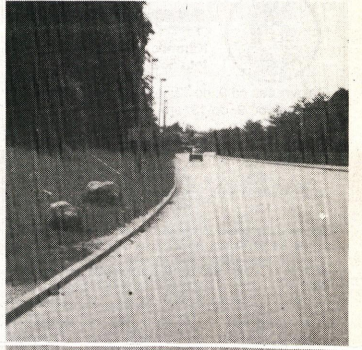
Velike skale so priletele s pobočja Starega gradu na cesto obvoznico in zaprle promet.
