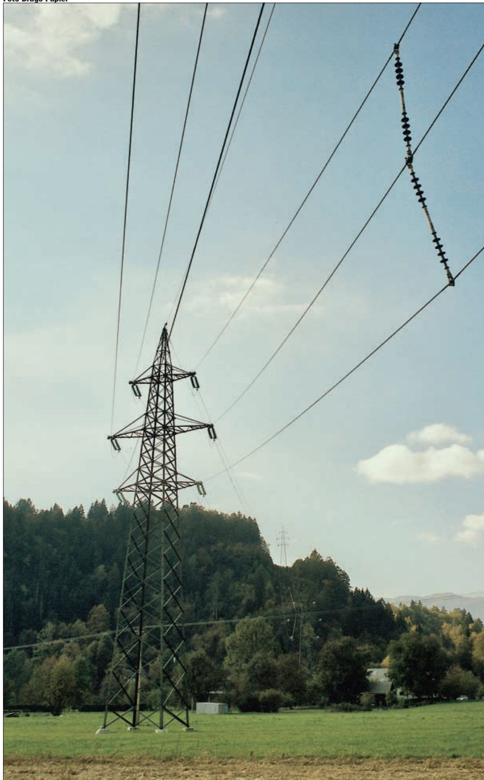
35 kV (zgrajen za 110 kV napetost) daljnovod Bled-Bohinj, zgrajen leta 1988 in opremljen z izoliranimi distančniki leta 1998.
