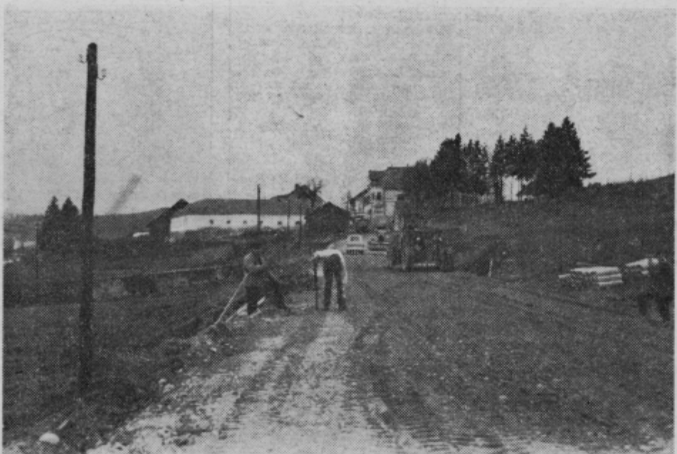
Dela pri rekonstrukciji Obsoteljske ceste lepo napredujejo. Doslej so delavci Cestnega podjetja iz Celja že uspeli asfaltirati cestišče od železniškega prelaza pod Snehovim klancem pa do Pristave. Če bo vreme lepo, bodo z asfaltom prevlekli še letos cesto do zavoja pri železniškem prelazu pred Sodno vasjo. Foto: J. Sever
