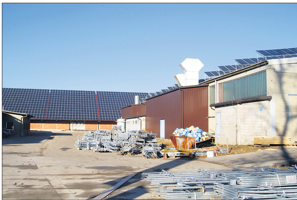
Na prostoru nekdanjega kidričevskega obrata Pleskarja sta sedaj že dva objekta s sončnimi elektrarnami na strehah.
