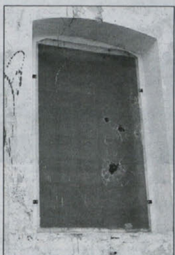
Zunanost poškodovanega okna
