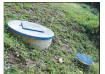
Črpalni jašek za hišni priključek vodovodnega omrežja na tabor
