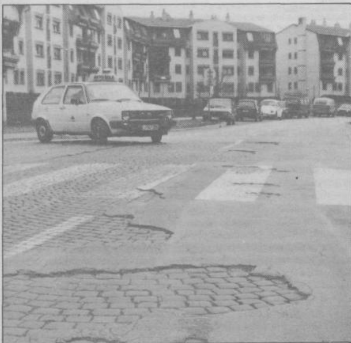
„Samajama“, kot vse pogosteje uporabljajo krajan Šentvida ime za Prušnikovo ce- sto, vse bolj cveti. To zelo s pridom uporabljajo tudi avto šole, ker se lahko bodoči vozniki najbolje prilagodijo slovenskim cestnim razmeram. Slišati je pa je, da nove- ga asfalta ne bodo položili vse dotlej, dokler se ne bodo pokazale tramvajске tirni- ce, ki jih bodo uporabili za „novi“ mestni promet.
